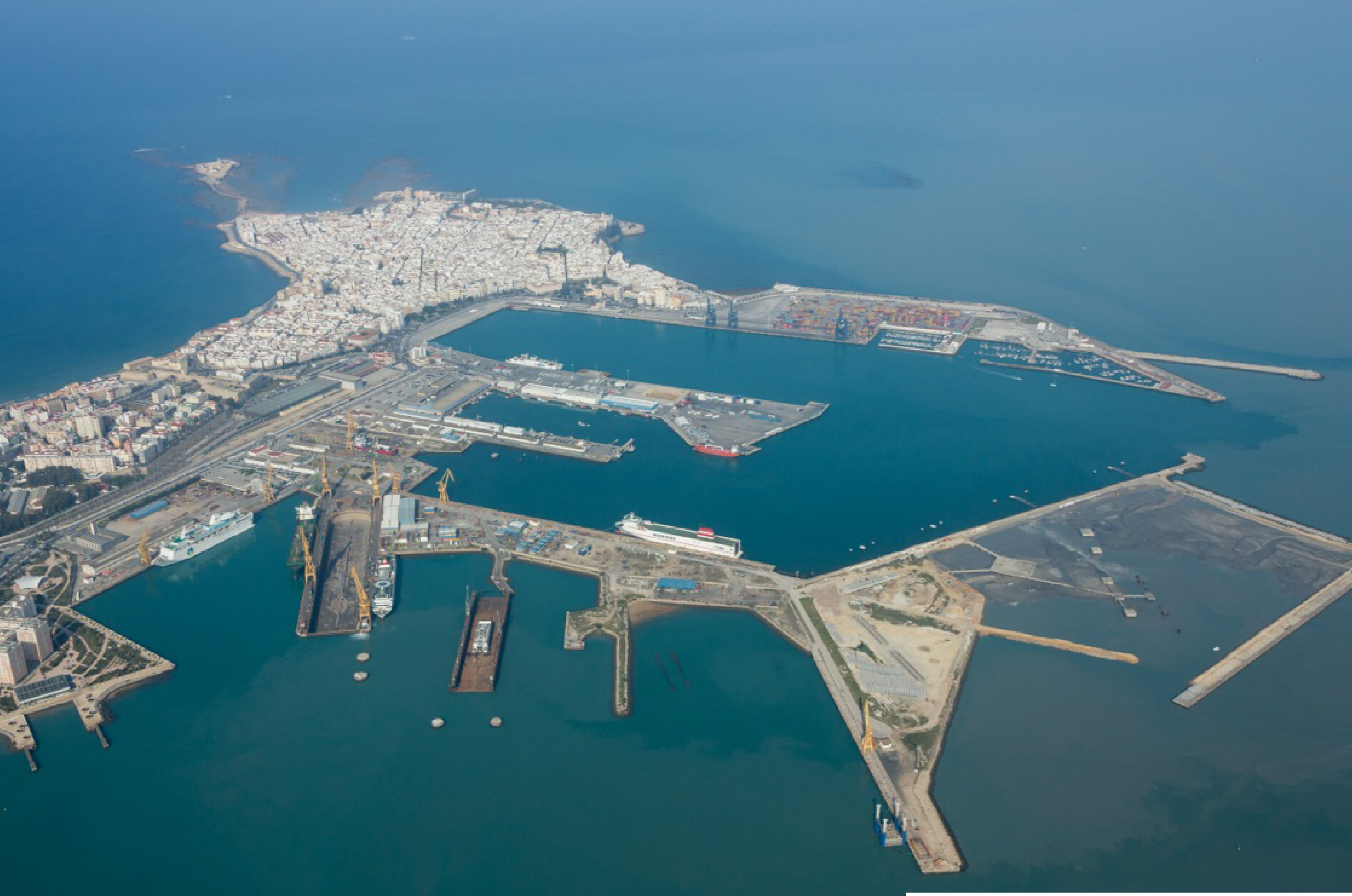
Obras de la nueva terminal de contenedores. Marzo 2014. Works at new container terminal. March 2014.
