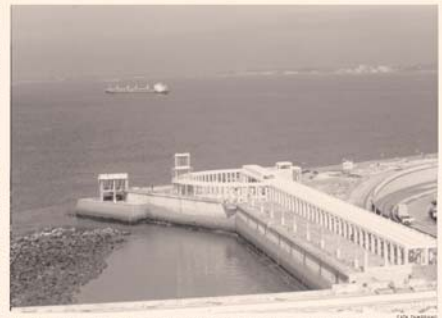
El pavimento del paseo marítimo de la Punta de San Felipe se encuentra en un estado deplorable.
