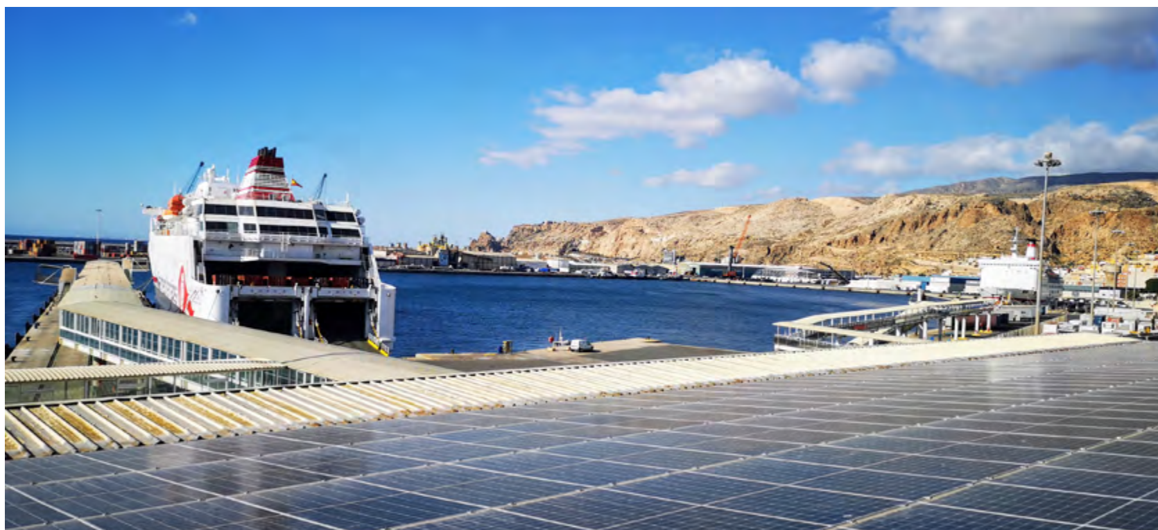
PLACAS FOTOVOLTAICAS EN ESTACIÓN MARÍTIMA
