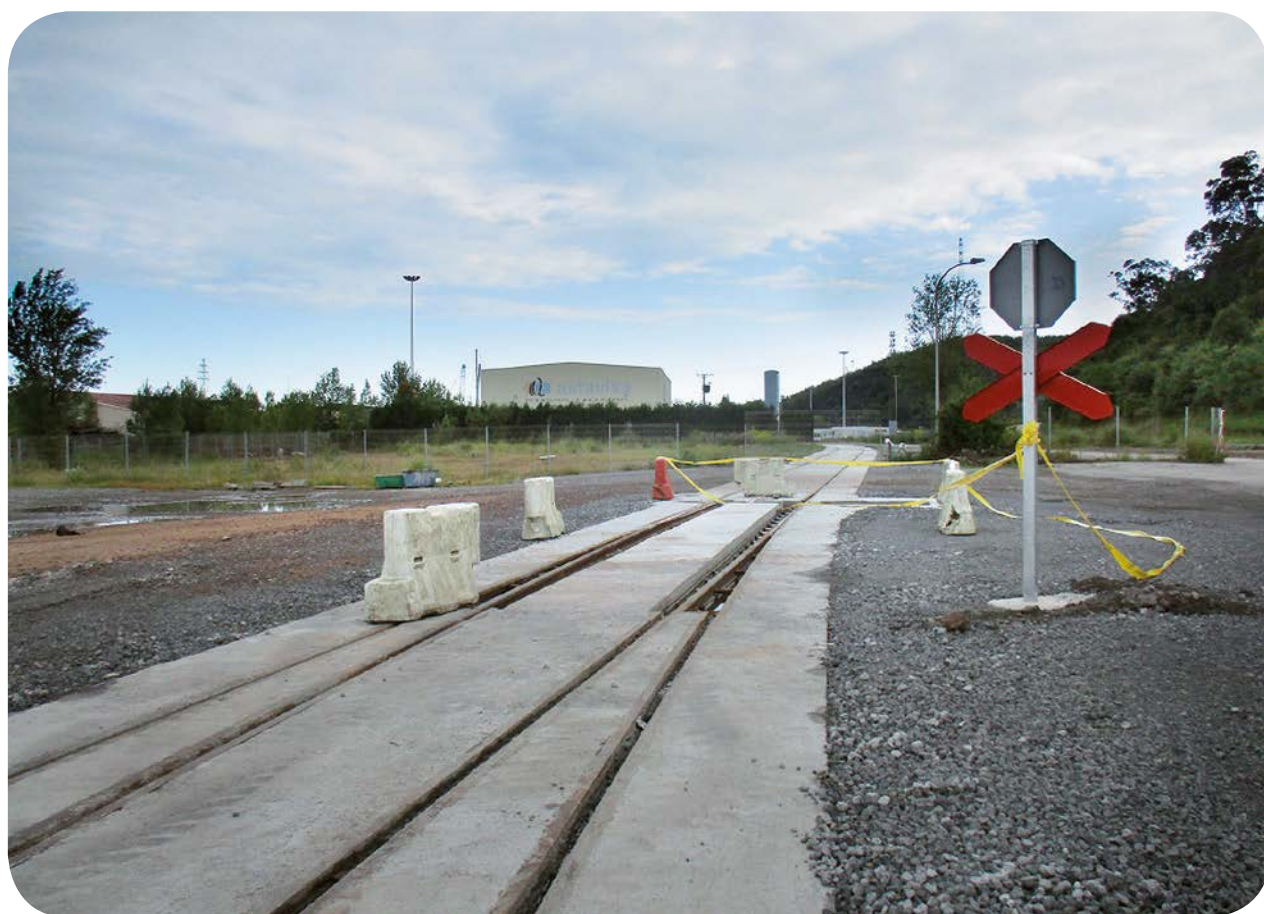
➤ Señalización instalada a pie de vía. / Signalling installed alongside the track.
