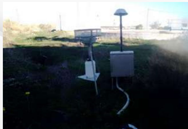
Estación de Muestreo Depuradora Punto nº4.
