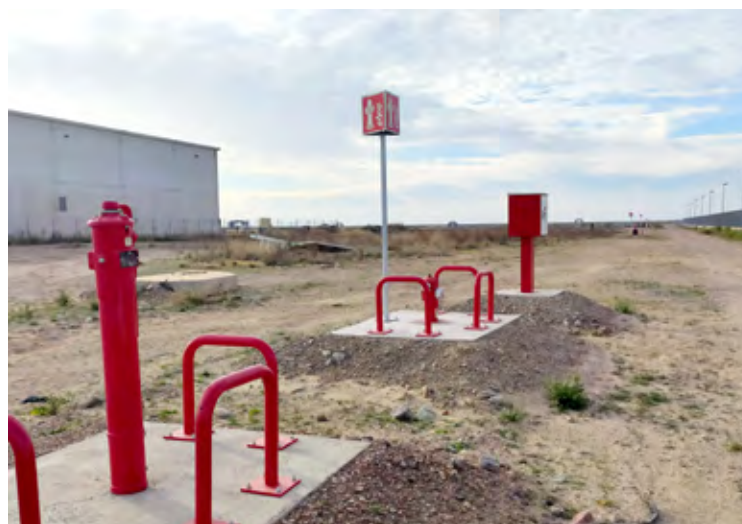
► Válvula de sectorización, hidratante y armario suministros
