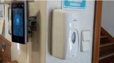
Sistema de fichaje por reconocimiento facial y lector de temperatura a la entrada de los edificios
