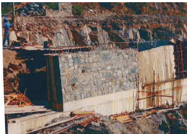
Fotografía 6. Muro en ambiente marino [40]
