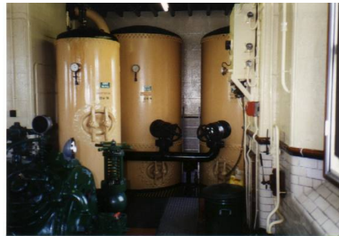
Fig. 5 Receptores de aire y equipo de señales de niebla
