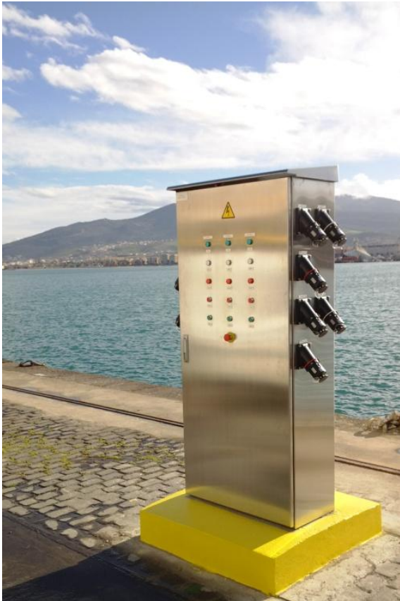
Figura 5.6 Monaguillo de conexión a buques en el Muelle Espigón, Puerto de Melilla
