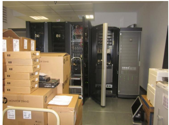
Figura 4.1.7 Armarios de racks del CPD de la sede de oficinas de la APT
