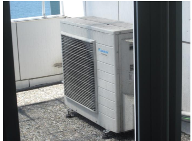
Figura 4.2.10 Bomba de calor – Unidad exterior
