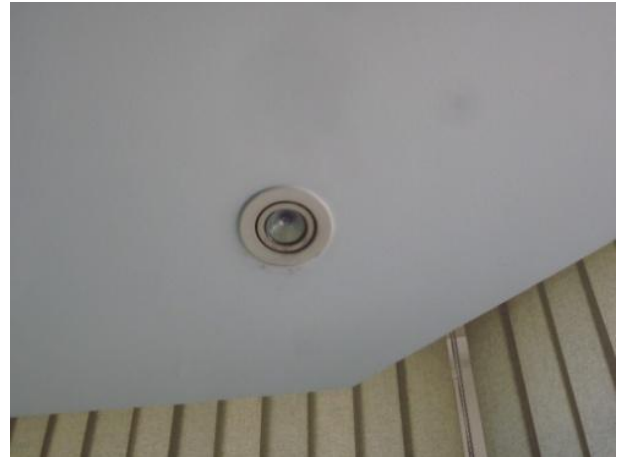
Figura 4.2.5 Lámpara halógena del edificio de Port Control
