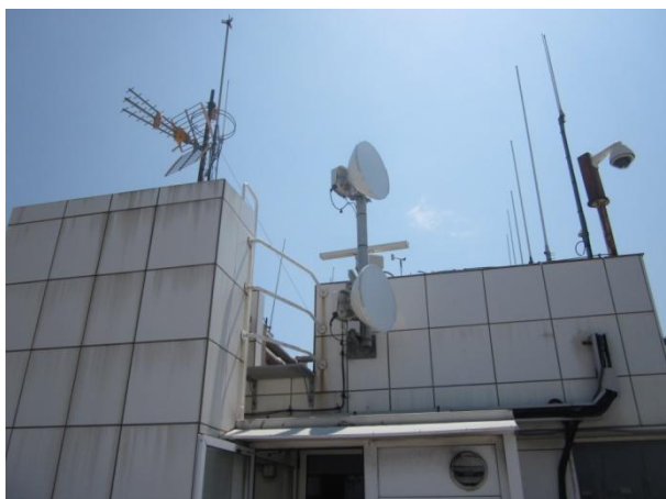
Figura 4.2.13 Otros consumidores – Equipos de control
