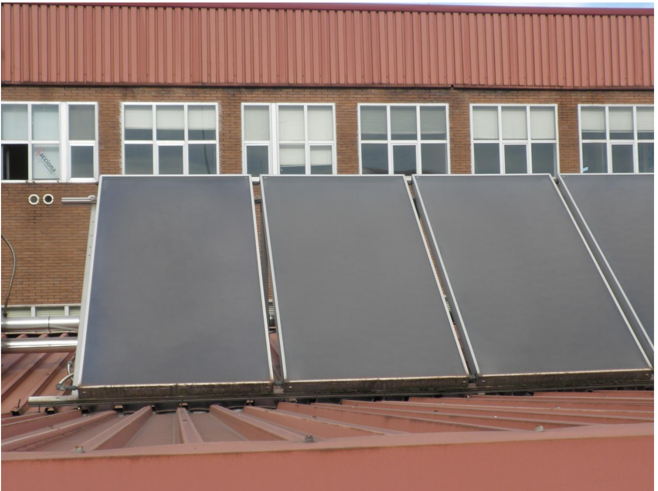
Figura 2.4.1 Instalación solar térmica para ACS en el Puerto de Gijón
