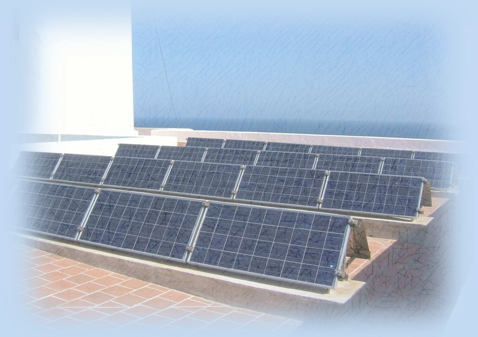
Instalación solar fotovoltaica en el Faro de Cavallería (Menorca)
