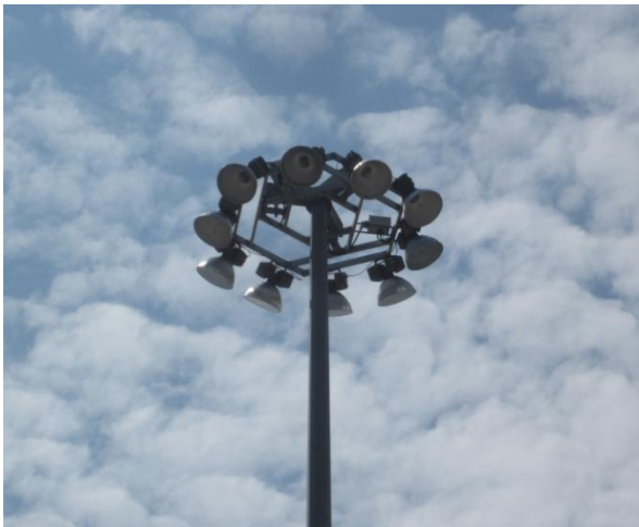
Figura 4.1.4 Torre de proyectores de vapor de sodio a alta presión del puerto de Tarragona
