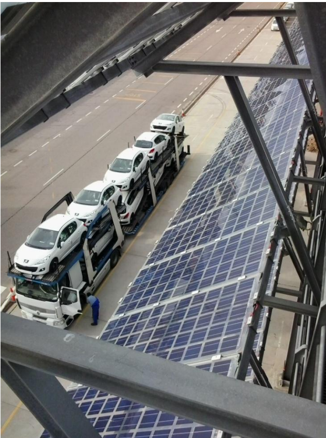
Figura 2.4.3 Instalación solar fotovoltaica en silo de automóviles de la AP de Vigo
