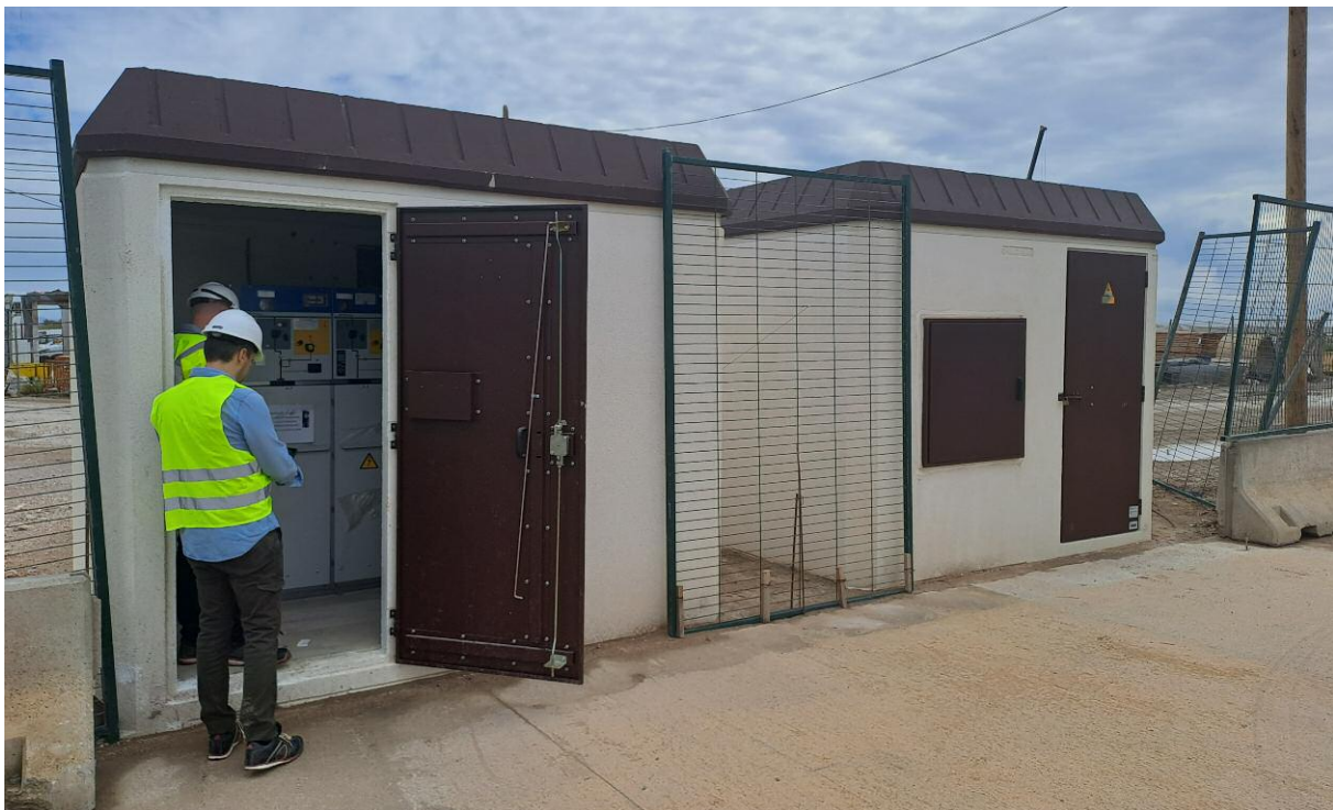
Centro de Seccionamiento y Centro de Recepción Protección y Medida.
